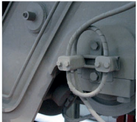
Neu: Optimierte Verkabelung
